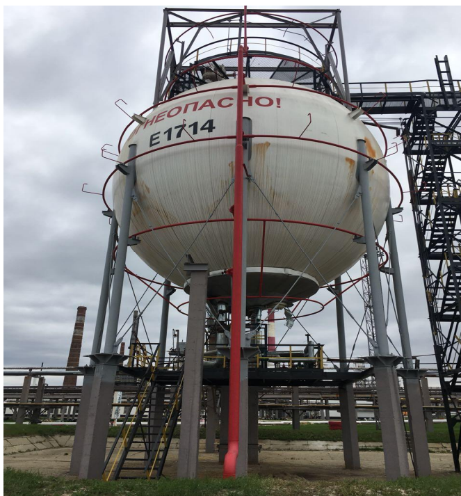
Рисунок 1 - Общий вид резервуаров шаровых стальных РШС-600
